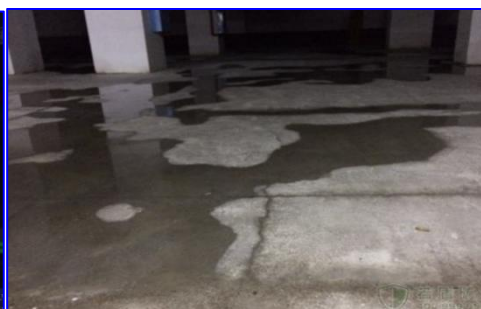
图2 地下室车库渗水现象
