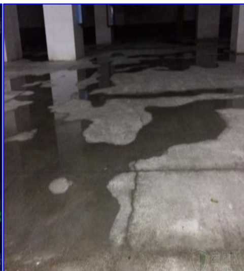
图2 地下室车库渗水现象
